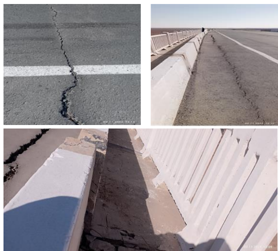
2-Rasm. Yo'l o'tkazgichning asfalt-beton qoplamasidagi yoriqlar
