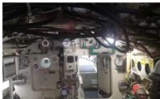
Рис. 2. Шлюзовая камера щита (Ташкент-2018)
