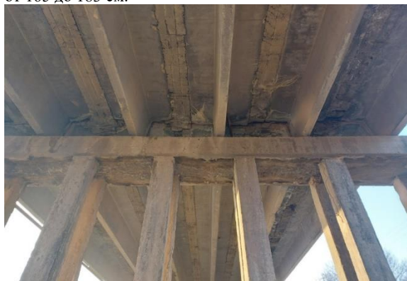
Рис. 2. Обзор дефектов в пролетном строении моста
